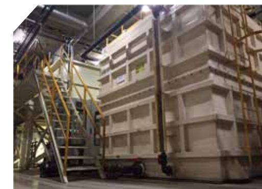
無機廢水處理系統
