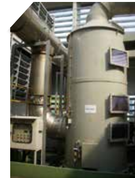
中央洗滌塔照片
